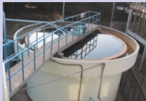
Effluent Treatment Plant (ETP)
